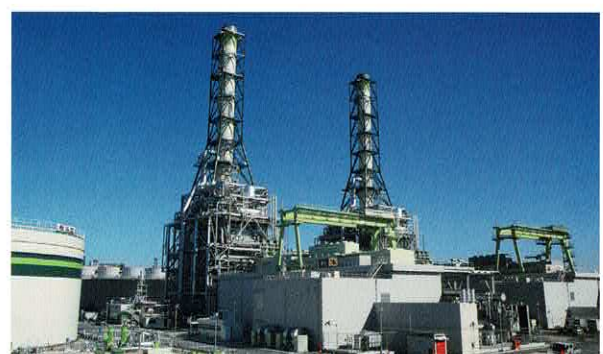
川崎天然ガス発電
